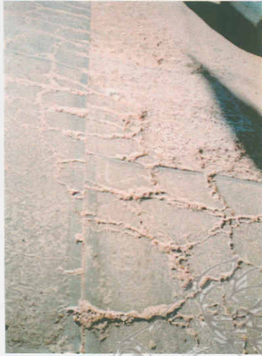
Foto 9. Estallamiento de Superficie
