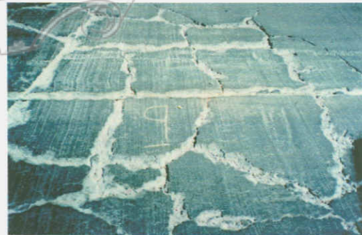
Foto 8. Estallamiento de Superficie
