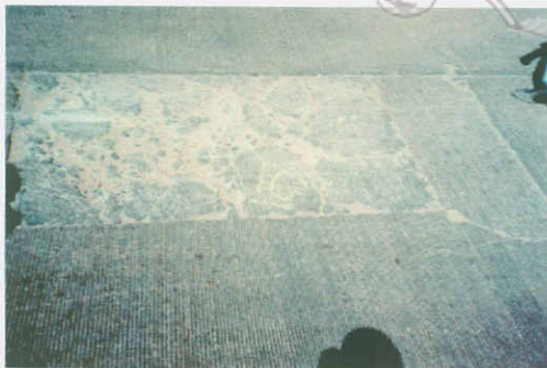
Foto 12. Falla por Corte al Pavimento.
