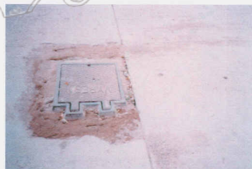
Foto 13. Falla por Corte al Pavimento.
