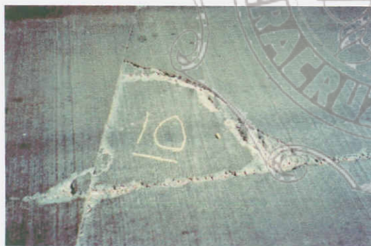
Foto 1. Grieta en Esquina
