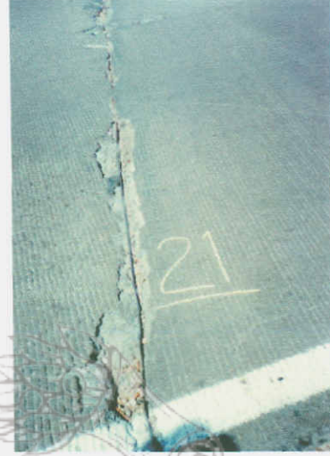
Foto 4. Desprendimiento en Junta
