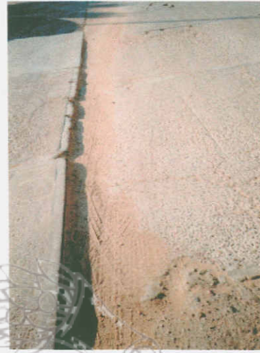
Foto 10. Diferencia en Elevación entre Losas a lo Largo de la Junta.
