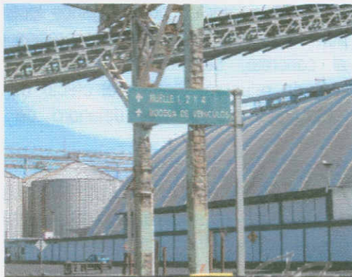
Imagen 4.9. Deterioro de estructuras de concreto en el interior de la zona portuaria
